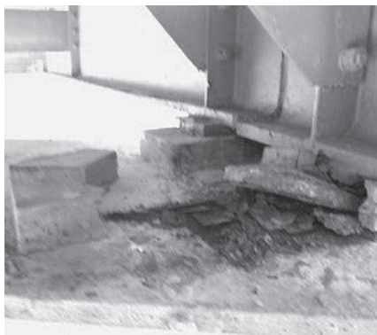
(d)支承の破損・段差
